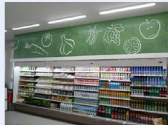
インドネシア・ジャカルタ市内の店舗にCO 2 冷媒要冷機器等を導入
