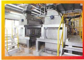
生ごみ分別機(2基)
