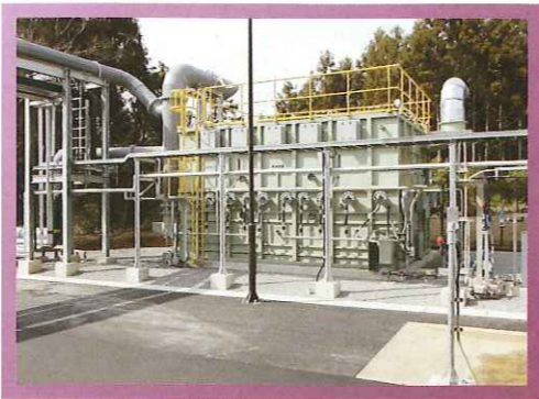
生物脱臭設備
