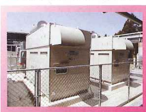
ガスエンジン(2基)
