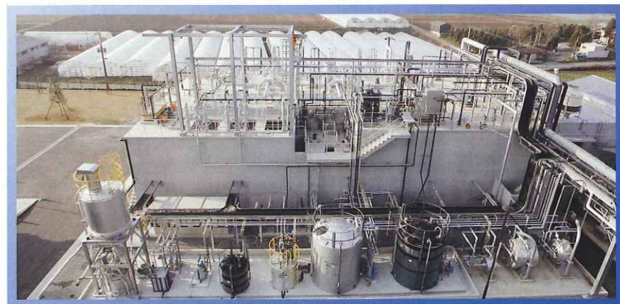
排水処理設備全景
