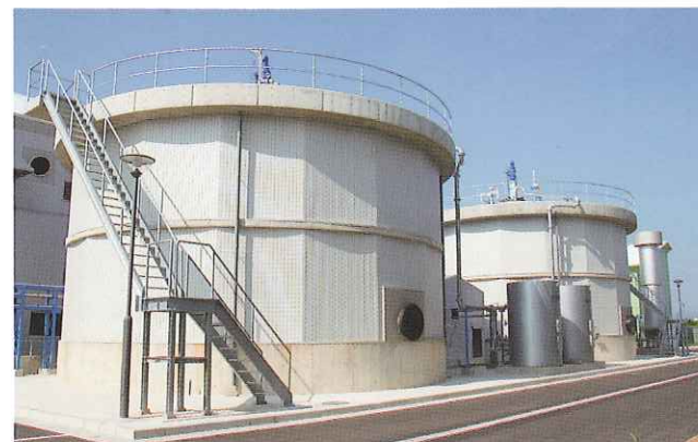
■メタン発酵槽 生ごみをメタン発酵させて、バイオガスを発生させます。
