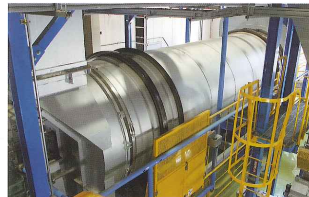
■汚泥乾燥機 下水汚泥と脱水汚泥を、熱風で乾燥させます。バイオガスと木質原料を燃料とします。
