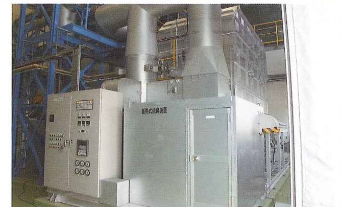
■蓄熱脱臭装置 乾燥排ガスを燃焼し悪臭成分を除去します。熱交率の良い蓄熱方式を採用します。
