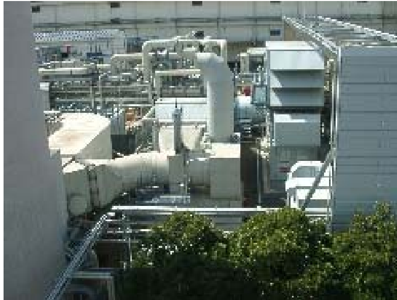
横浜磯子事業場 第2コージェネレーションシステム
