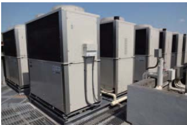
横浜磯子事業場 GHP空調設備
