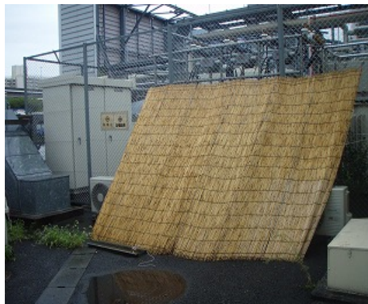
空調室外機前にヨシズ設置
