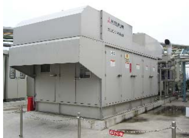
堺事業場 コージェネレーション設備
