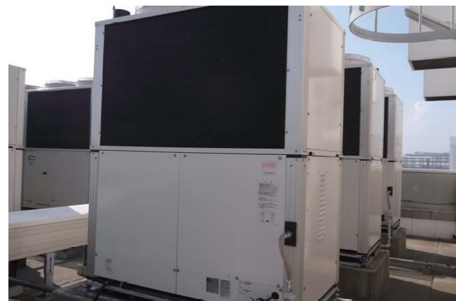
堺事業場 GHP空調設備
