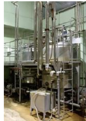
←プリン原料保温タンク
