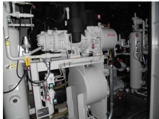
自然冷媒2元冷凍設備
