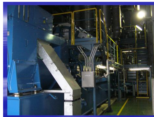
ガスエンジン
