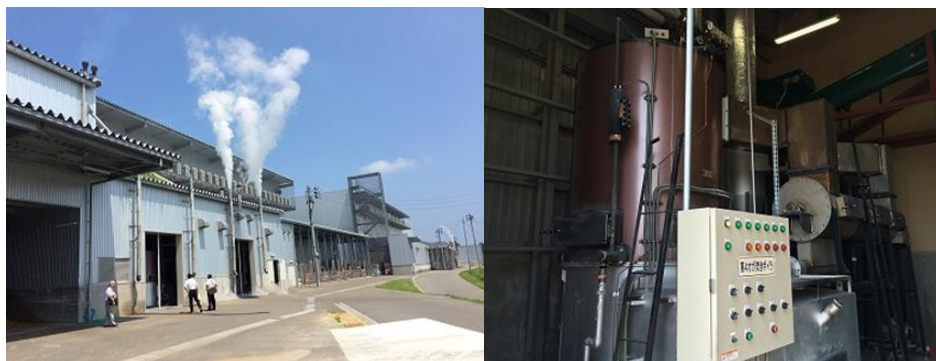
松之山なめこ工場（きのこ廃菌床を燃料利用しているボイラー）
