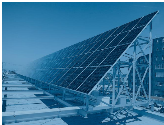
平川市役所の太陽光パネル
