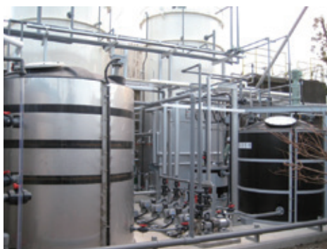
プラント外観
