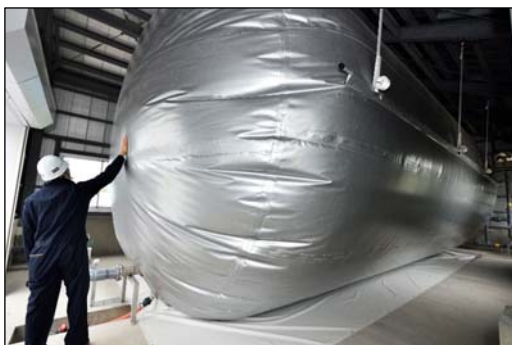
ガスバック室
