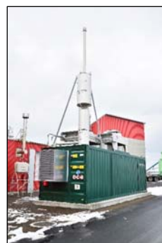
発電施設(民間)
