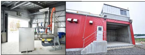
固液分離機・室
