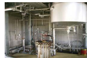
上高瀬作業場に設置されている BDF 精製設備
