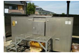
豊中町学校給食センター の生ごみ処理機
