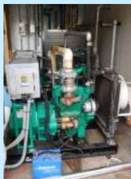
メタンガス発電機
