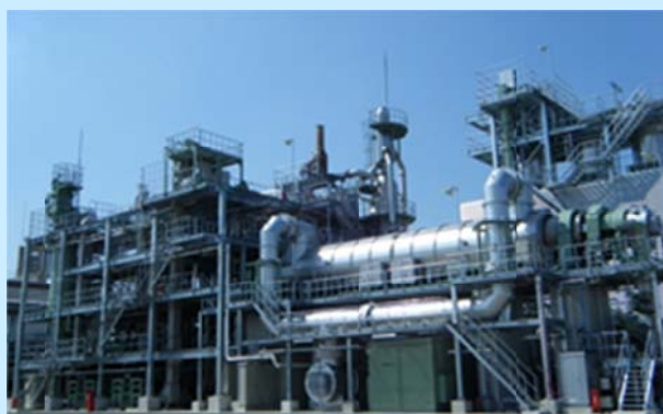
衣浦浄化センターの下水汚泥燃料化施設
