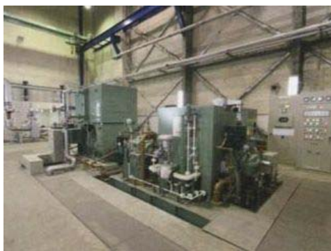
南部清掃工場の蒸気タービン発電機
