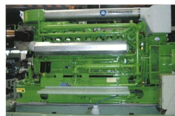
消化ガス発電装置
