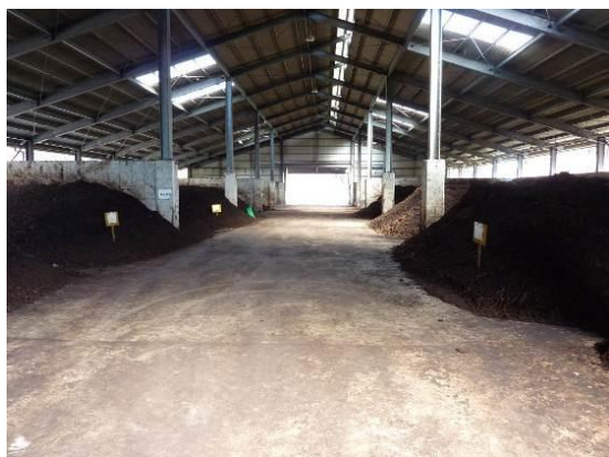
畜産農家 堆肥化設備
