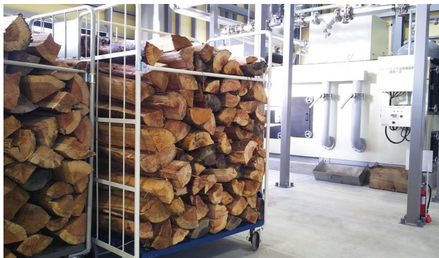
住宅団地熱供給施設内 薪・ボイラー
