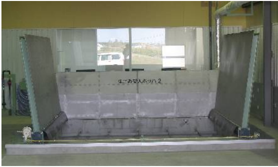
生ごみ投入口
