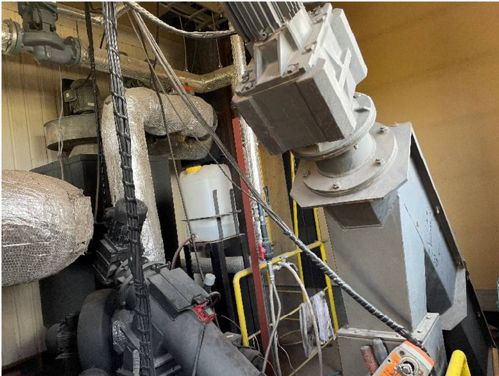
防火ダンパーと搬送スクリューコンベアー
