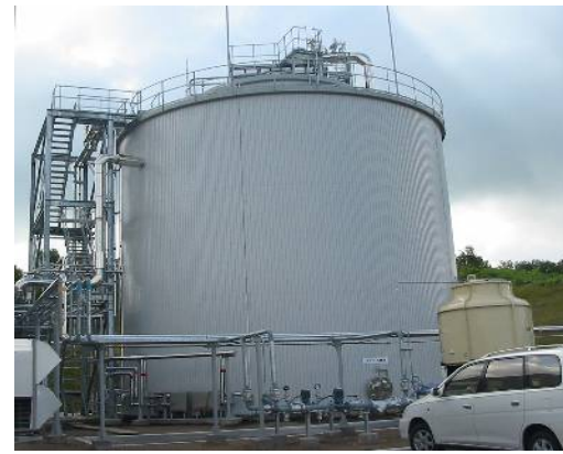
メタン発酵槽
