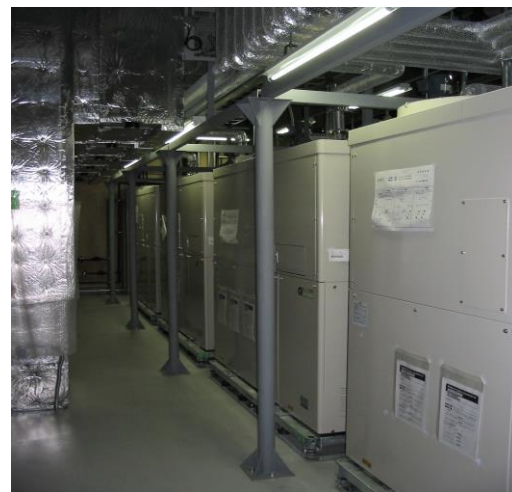
コ・ジェネガス発電機
