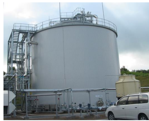
メタン発酵槽
