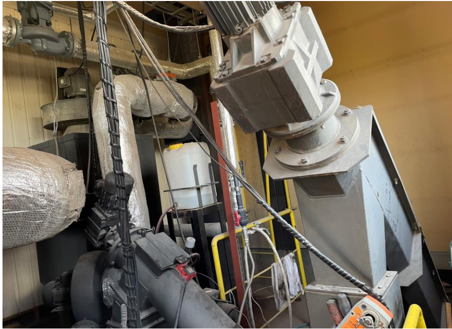
防火ダンパーと搬送スクルーコンベアー
